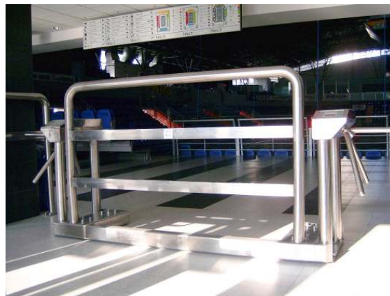
Izgled instaliranih trokrakih barijera (2)
