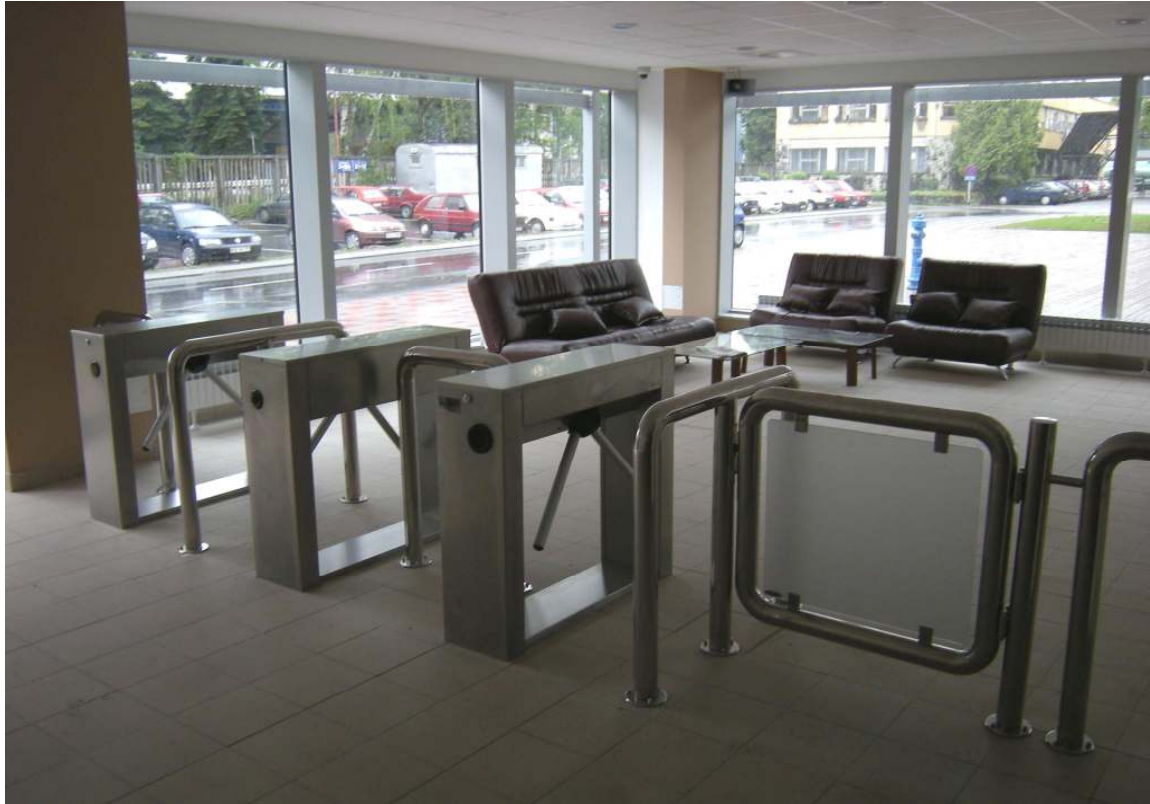
Izgled instaliranih trokrakih barijera (1)
