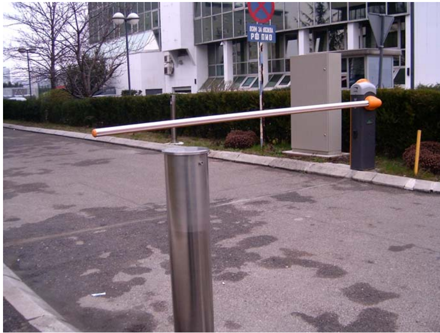
Sl.1 Primer rampe kontrolisane "proximity" terminalom sa dva čitača na stubićima od INOX-a
